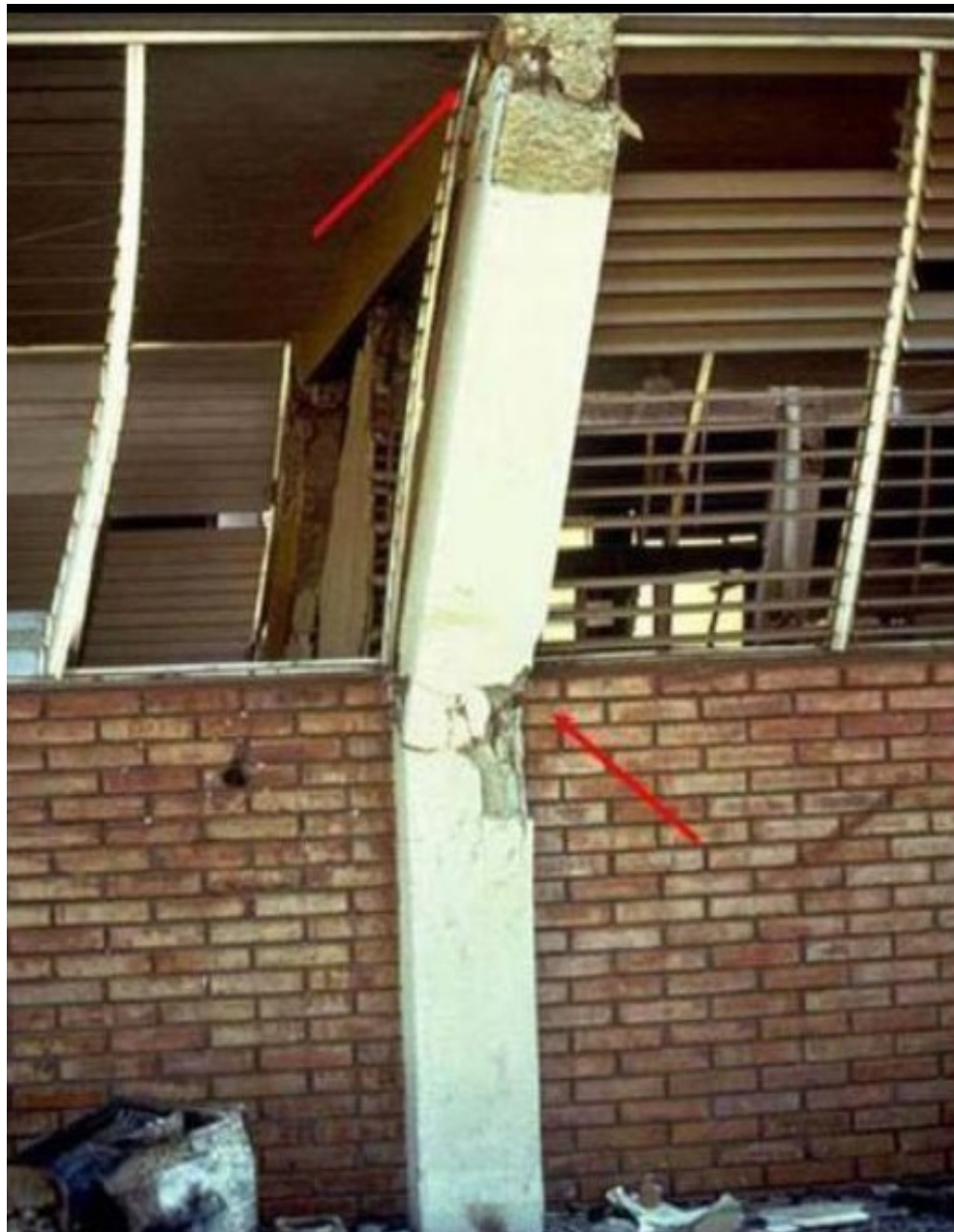
شکست برشی ناشی از تشکیل ستون کوتاه
